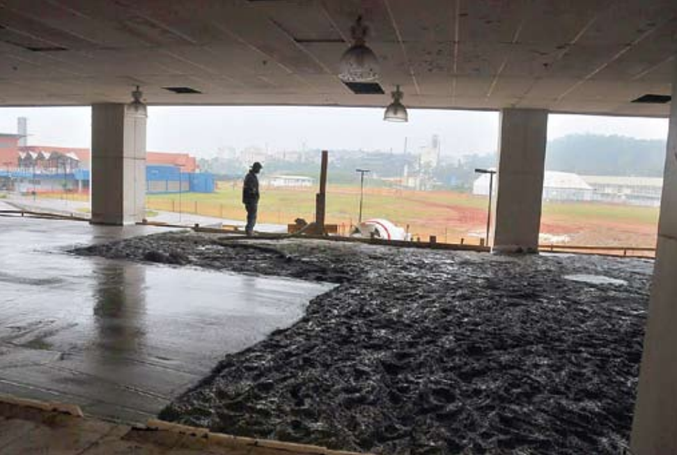
Obras embargadas pela Justiça em prédio da unidade
