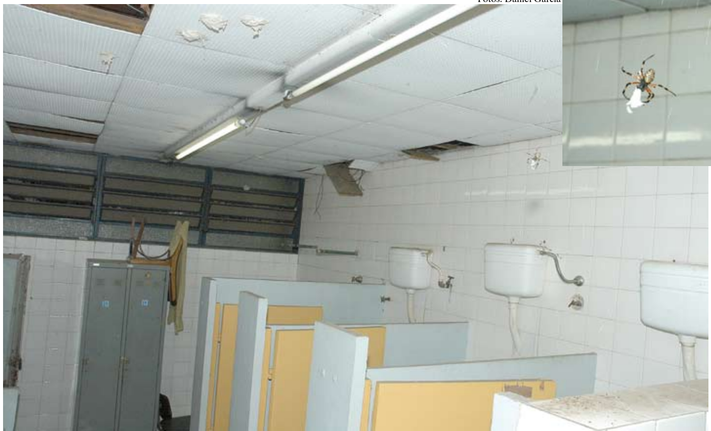
Vestiário de trabalhadores terceirizados na ECA: condições deploráveis e "criadouro" de aranhas no teto
