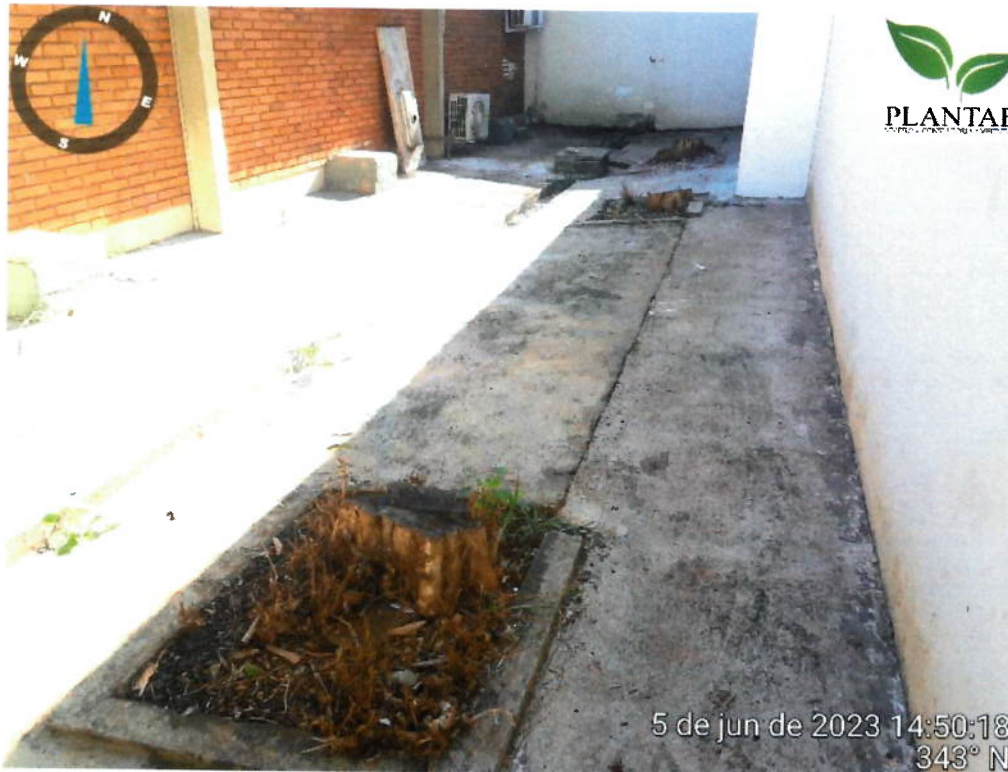
Foto 27. Demonstram áreas de alto conflito antrópico com a vegetação, onde foram realizados cortes para a conservação do patrimônio.
